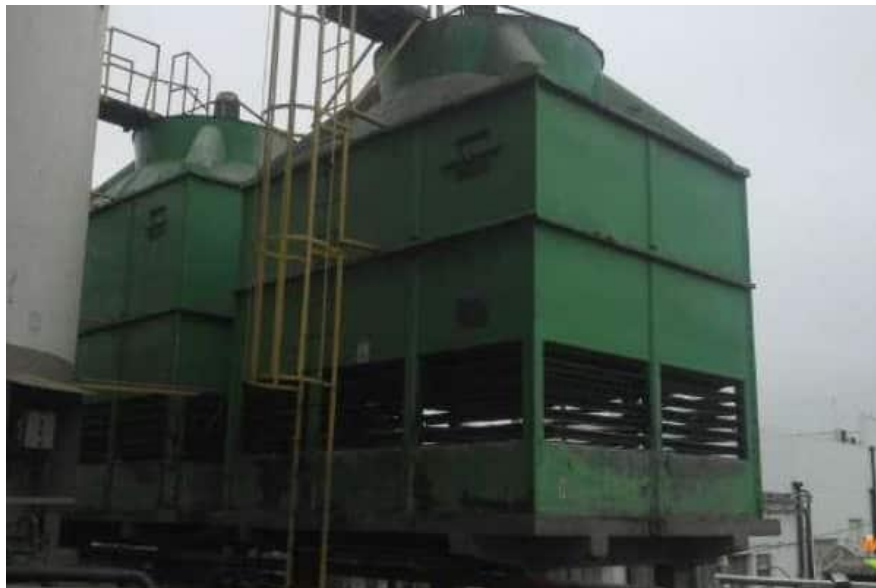
Figura 20 - Torre de resfriamento.
