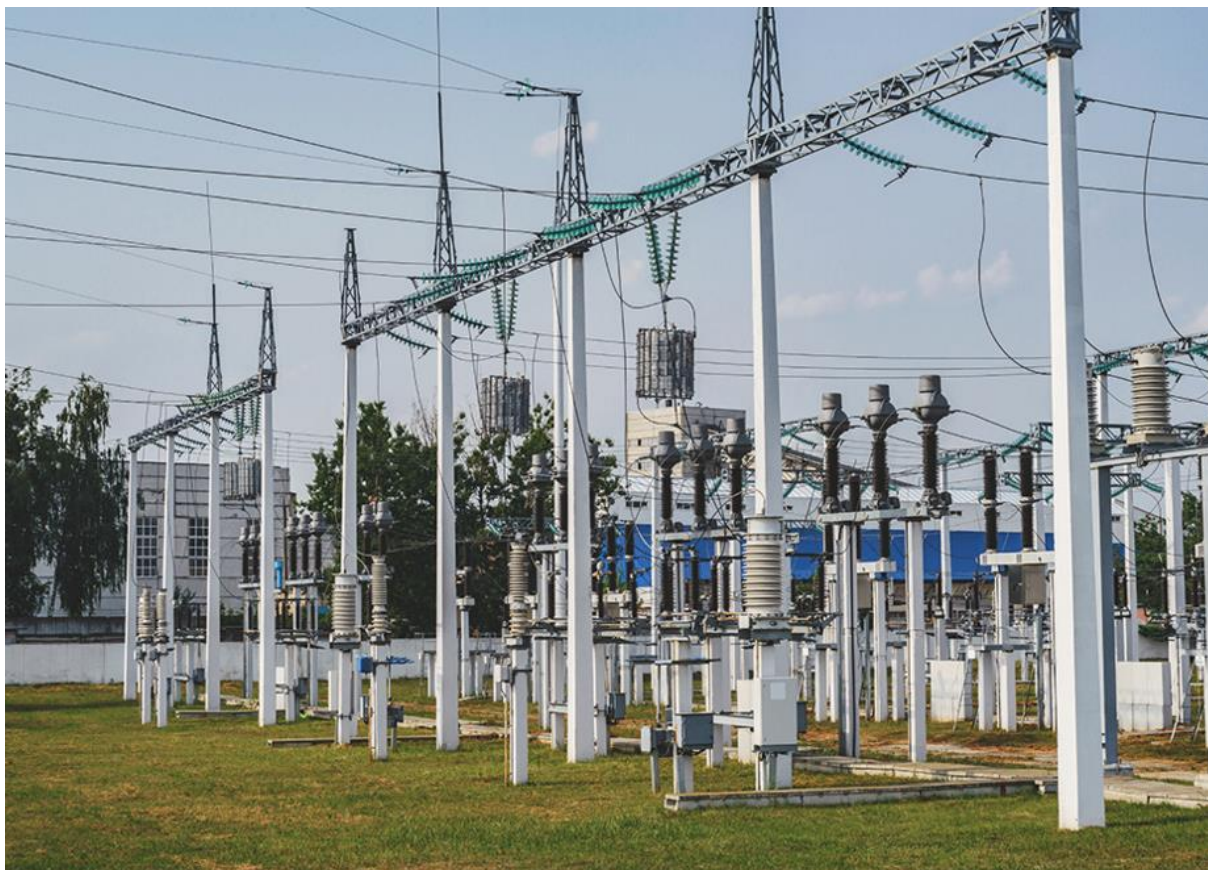
Figura 6.4 — Subestação Dörpen West
