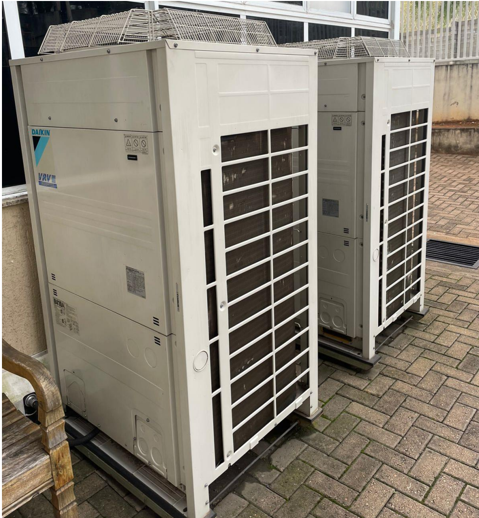
Figura 3.2 - Unidade condensadora do VRV
