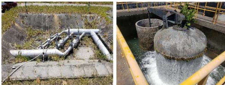
Figura 4.5.12 – Sistema de Caixa de Quebra Pressão da Deso, em Capela/SE Fonte – (Vitalux Ecoativa)
