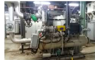
Chiller Antigo 200 TR | kW/TR 0,9
