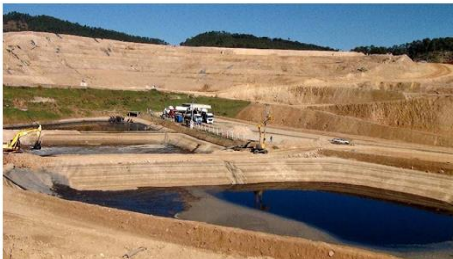
Figura 3.1 - Lagoa de acumulação de chorume na CVTA Caieiras.
